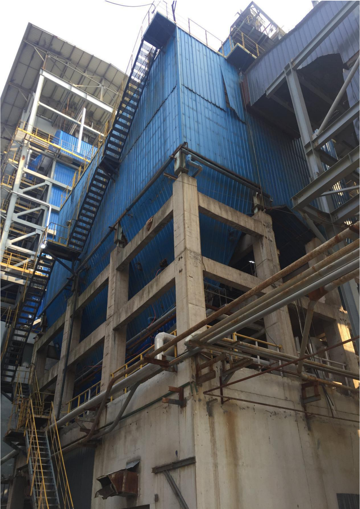
废气处理系统
