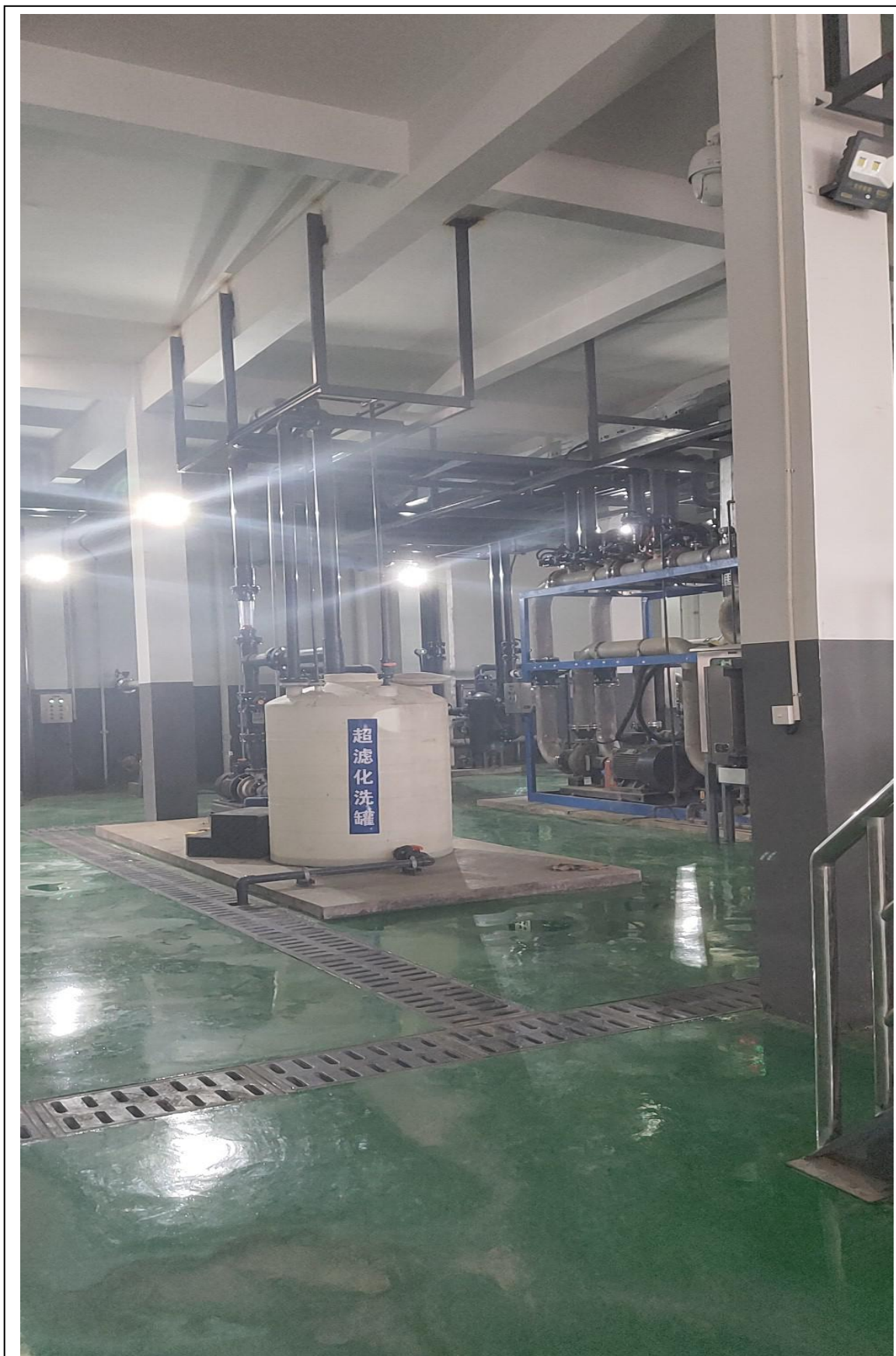
废水处理设施
