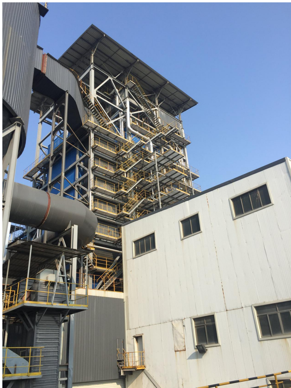
废气处理装置
